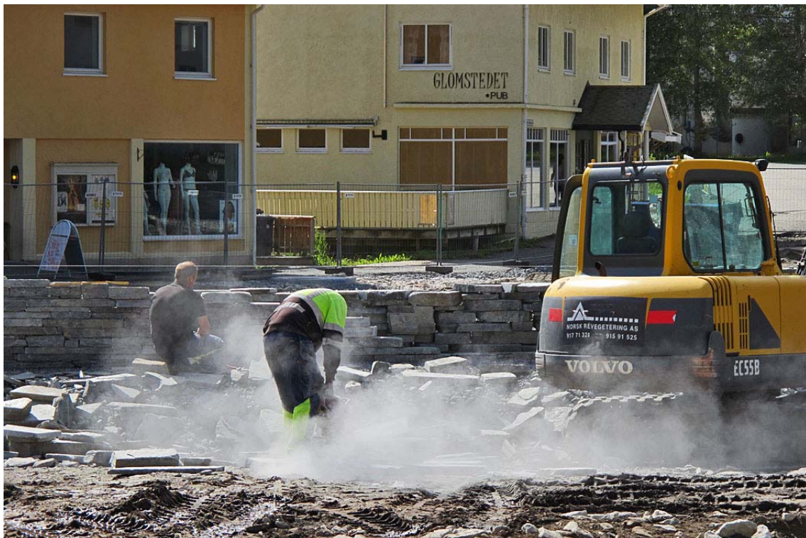
Arbeidet med å oppgradere Glomfjord sentrum pågikk for fullt sommeren 2015. Foto: Trond Skoglund.
