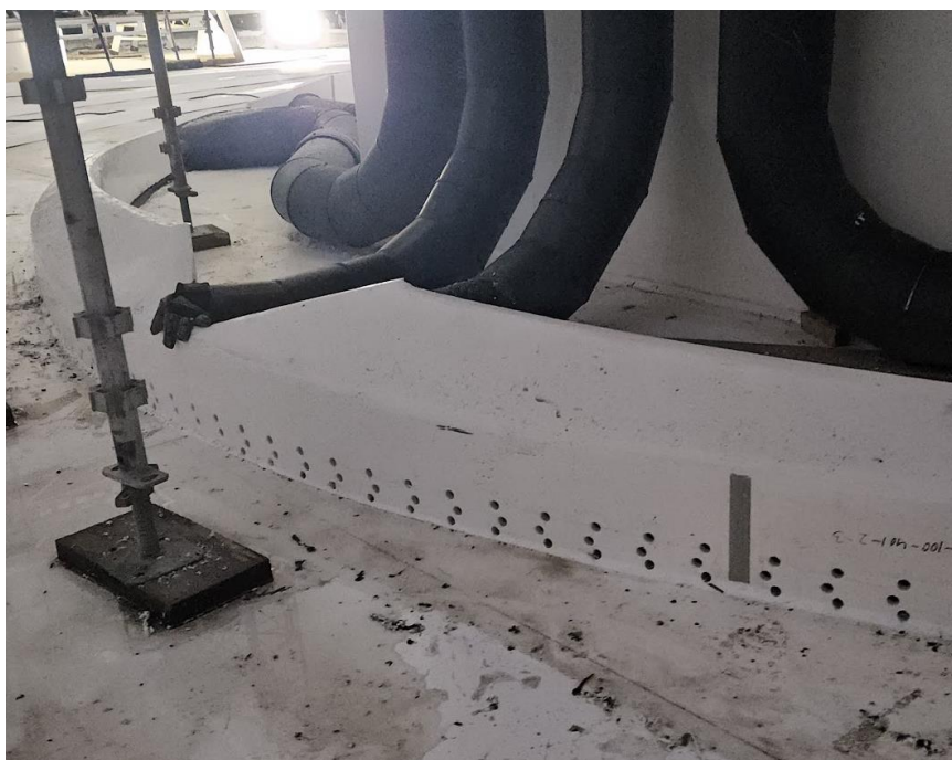
Figur 2. Perforert avløpsring (hvit) rundt senterkolonne tilkoblet sorte rør som løfter avløpsvann til syklon for separasjon. Bilde: 10K under oppføring, Fishglobe Technologies.
