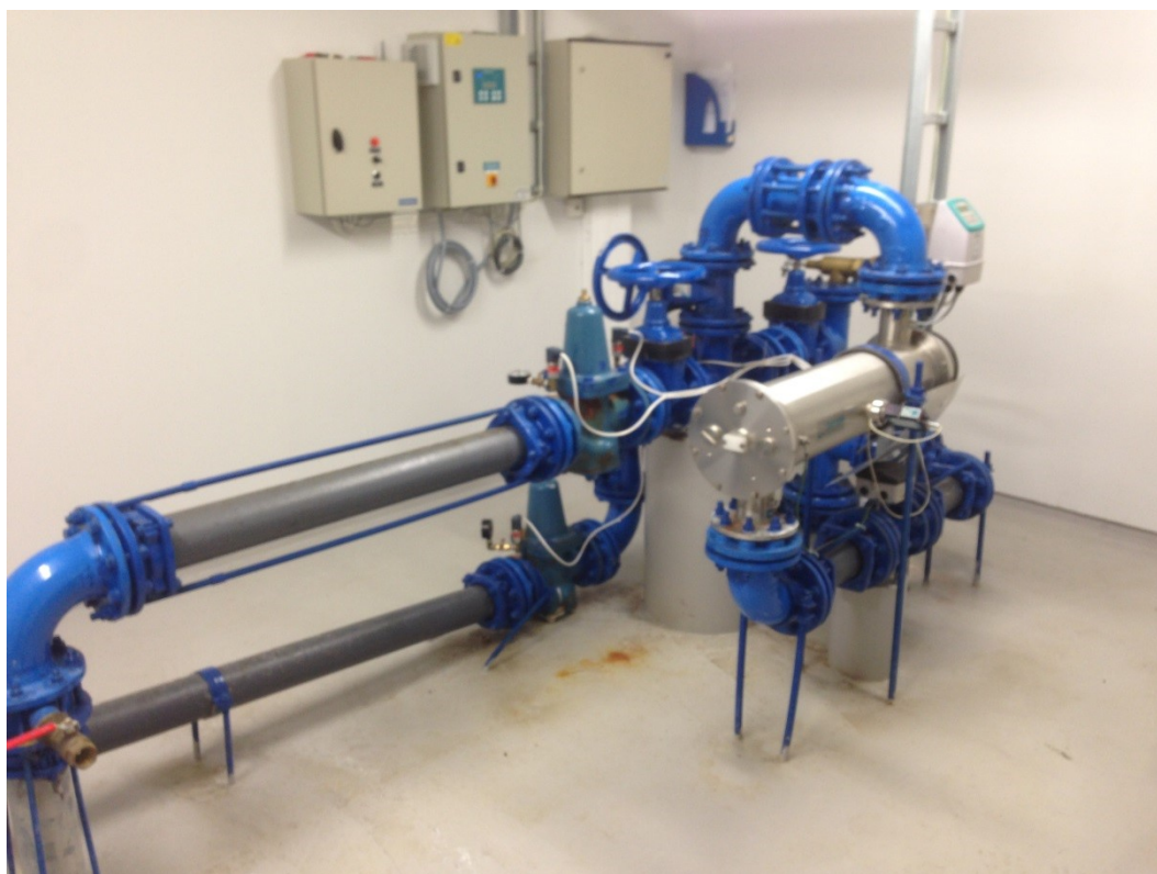
Bilde 4-3, viser UV- anlegget i Haugvika
