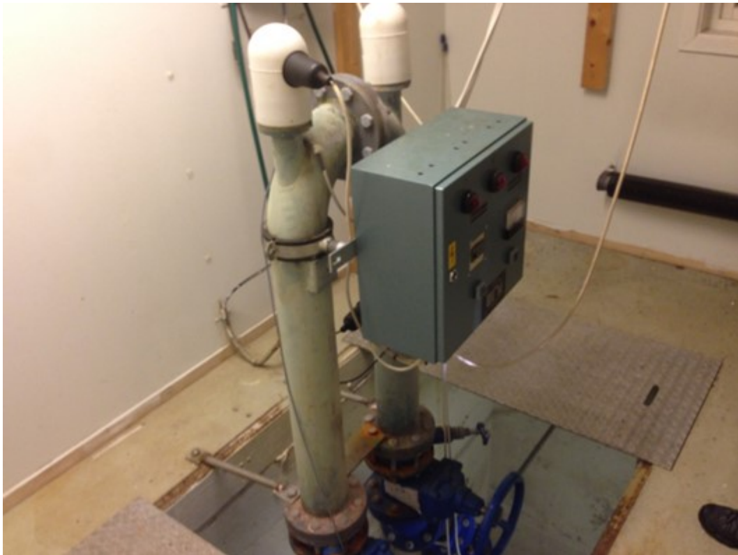
Bilde 4-4, viser UV-anlegget i Vassaksla
